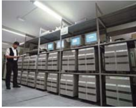
Rechenzentrum von SAP (in Walldorf) Gefährliche Gefahrenabwehr
